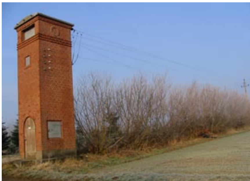
Transformator ved Fårup Huse
